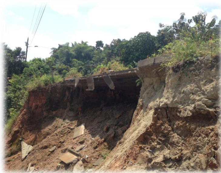
Estado crítico de la vía Flavio Alfaro – El Carmen
