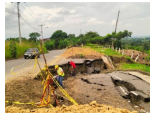
Hundimiento vía Chone-Canuto, 2024
