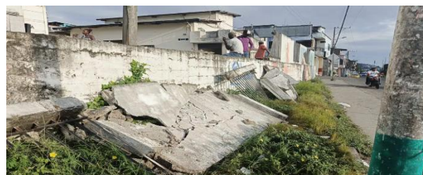
Muro del distrito de salud afectado.
