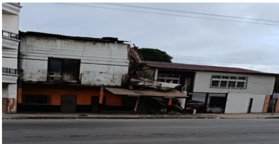
Varias viviendas afectadas.
