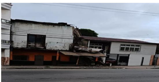
Varias viviendas afectadas.
