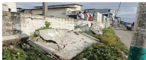
Muro del distrito de salud afectado.
