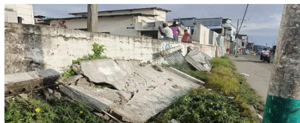
Muro del distrito de salud afectado.
