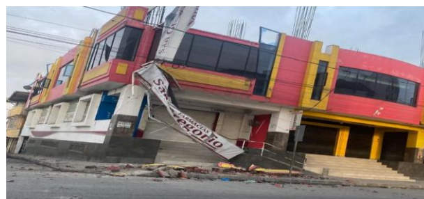
Locales comerciales afectados.
