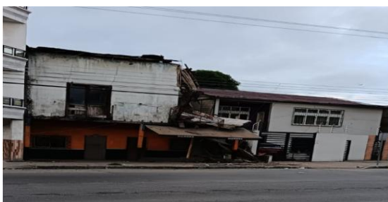
Varias viviendas afectadas.
