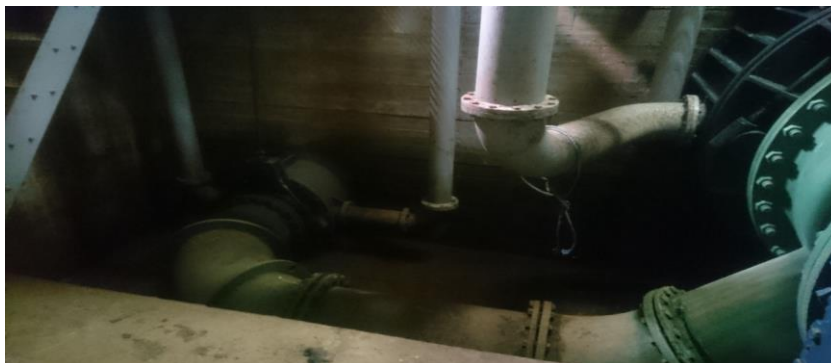
Ilustración 4: Imagen del problema de Captación de caudal ecológico entre válvula mariposa de Ø1.600 y válvula cónica de Ø1.500, en el desagüe de fondo del embalse Poza Honda en el Sistema Trasmases Manabí
