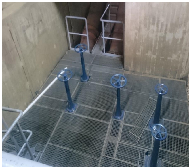
Ilustración 1: Imagen de obsolescencia del sistema de accionamiento en el desagüe de fondo del embalse Poza Honda en el Sistema Traslases Manabí
