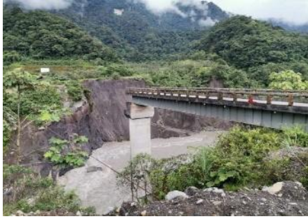
Colapso del puente Ventana 2, 19/05/2021
