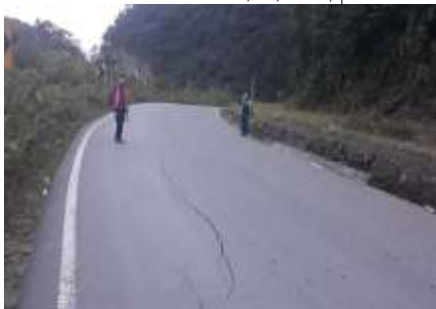
03/12/2021 aparición de nuevas grietas, vía E45 sector Piedra Fina
