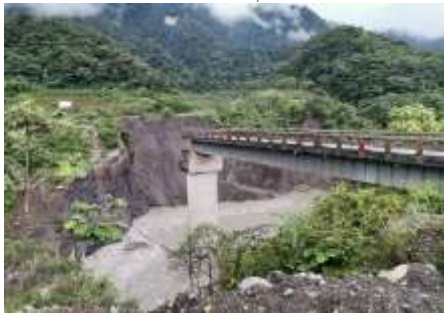
Colapso del puente Ventana 2, 19/05/2021
