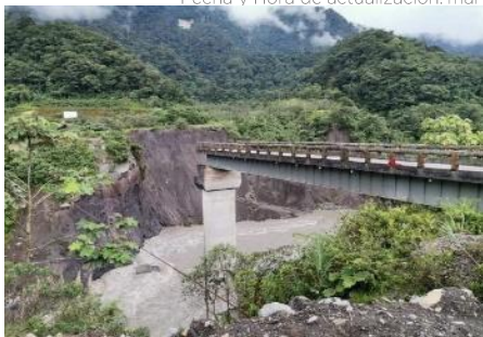
Colapso del puente Ventana 2, 19/05/2021
