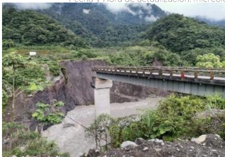
Colapso del puente Ventana 2, 19/05/2021
