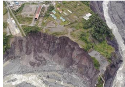
Riesgo por la inestabilidad de los taludes en la zona de la ventana 2 y San Luis, 31/07/2021,
