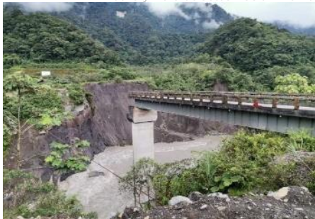
Colapso del puente Ventana 2, 19/05/2021
