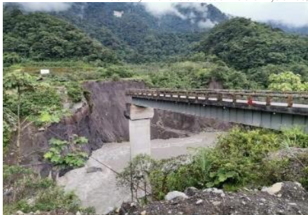
Colapso del puente Ventana 2, 19/05/2021
