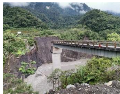
Colapso del puente Ventana 2, 19/05/2021
