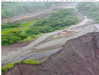
Pérdida de 520 metros de vía en el km 64 - vía E45 y de la vivienda denominada Casa Rosada en San Luis, 18/05/2021
