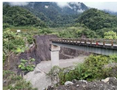
Colapso del puente Ventana 2, 19/05/2021
