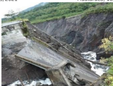
Colapso total del puente sobre el río Montana, 22/10/2020
