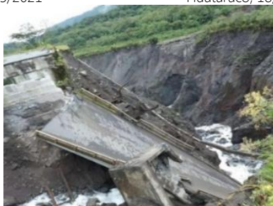
Colapso total del puente sobre el río Montana, 22/10/2020
