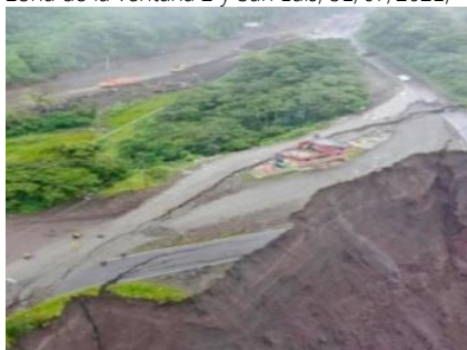
Pérdida de 520 metros de vía en el km 64 - vía E45 y de la vivienda denominada Casa Rosada en San Luis, 18/05/2021
