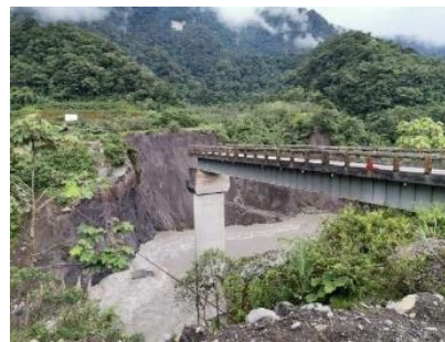
Colapso del puente Ventana 2, 19/05/2021
