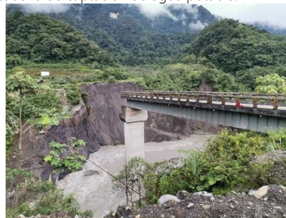
Fotografía 2. Fotografía del puente Ventana 2 ya colapsado
