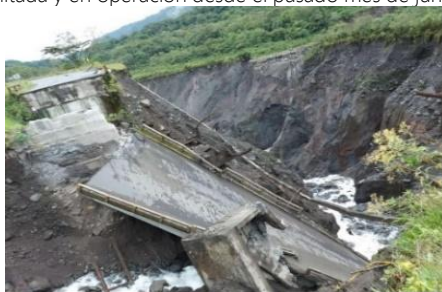
Fotografía 5. Colapso total del puente sobre el río Montana. Fuente: SNGRE C22 UMEVA Napo Orellana.
