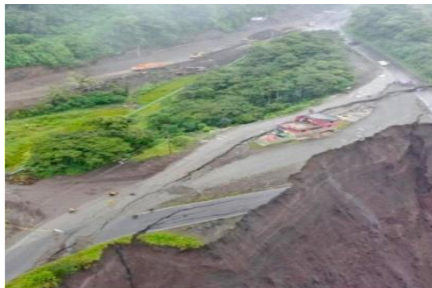
Fotografía 3. Fotografías aéreas de la vía Quito-Lago Agrio, sector El Reventador-San Luis, sitio casa rosada.
