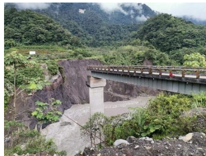
Fotografía 2. Fotografía del puente Ventana 2 ya colapsado
