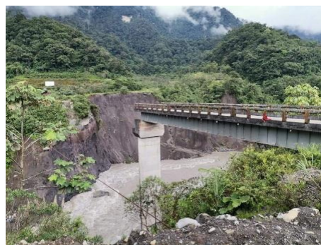
Fotografía 2. Fotografía del puente Ventana 2 ya colapsado
