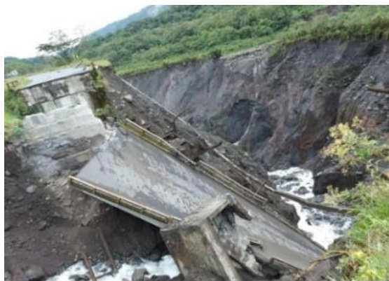
Fotografía 6. Colapso total del puente sobre el río Montana. Fuente: SNGRE CZ2 UMEVA Napo Orellana.
