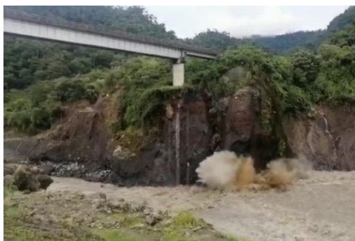
Fotografía 1. Momento en que la base del puente Ventana 2 es socavada por la corriente del río Quijos
