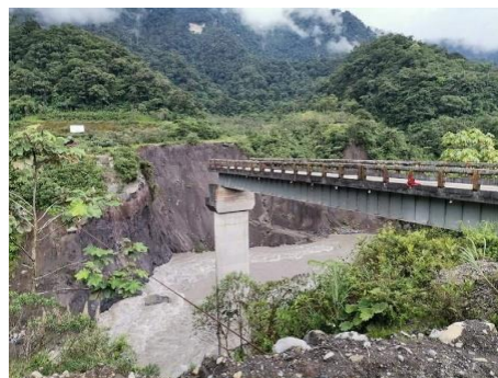
Fotografía 2. Fotografía del puente Ventana 2 ya colapsado
