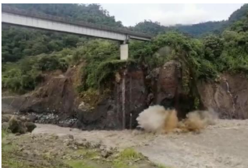
Fotografía 1. Momento en que la base del puente Ventana 2 es socavada por la corriente del río Quijo
