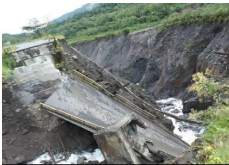
Fotografía 5. Colapso total del puente sobre el río Montana. Fuente: SNGRE CZ2 UMEVA Napo Orellana.
