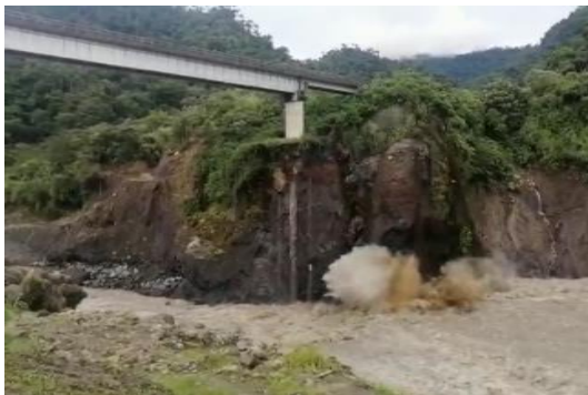
Fotografía 3. Momento en que la base del puente Ventana 2 es socavado por la corriente del río Quijos.
