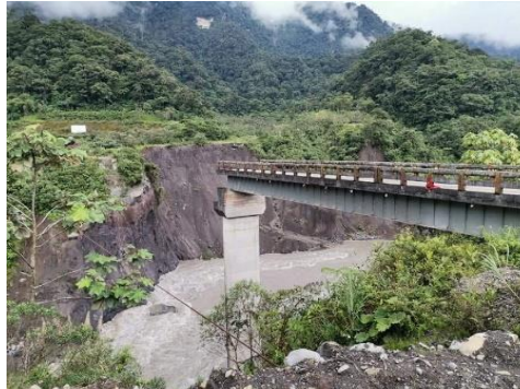
Fotografía 4. Fotografía del puente Ventana 2 ya colapsado.
