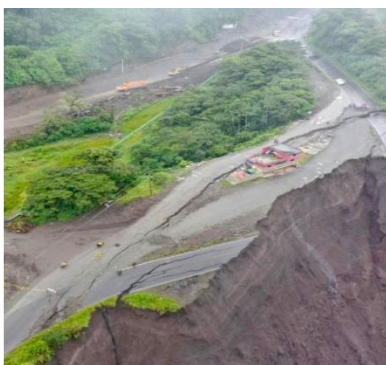
Fotografía 5. Fotografías aéreas de la vía Quito-Lago Agrio, sector El Reventador-San Luis, sitio casa rosada.
