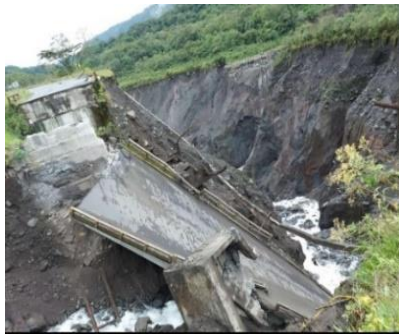
Fotografía 7. Colapso total del puente sobre el río Montaña. Fuente: SNGRE C22 UMEVA Napo Orellana
