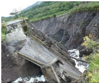
Fotografía 5. Colapso total del puente sobre el río Montana. Fuente: SNGRE CZ2 UMEVA Napo Orellana
