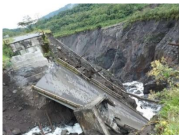
Fotografía 3. Colapso total del puente sobre el río Montana. Fuente: SNGRE CZ2 UMEVA Napo Orellana
