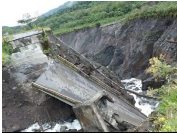
Fotografía 2. Colapso total del puente sobre el río Montaña. Fuente: SNGRE CZZ UMEVA Napo Orellana
