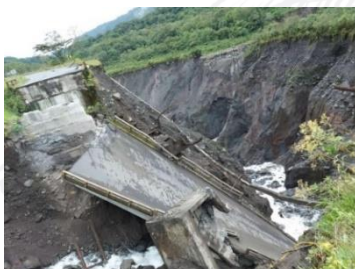
Fotografía 4. Colapso total del puente sobre el río Montana. Fuente: SNGRE C22 UMEVA Napo Orellana
