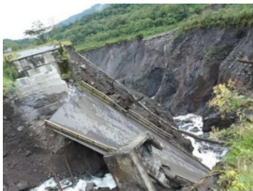
Fotografía 4. Colapso total del puente sobre el río Montana. Fuente: SNGRE CZZ UMEVA Napo Orellana
