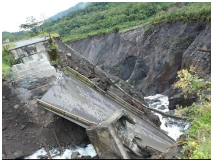
Fotografía 3. Colapso total del puente sobre el río Montaña. Fuente: SNGRE CZZ UMEVA Napo Orellana
