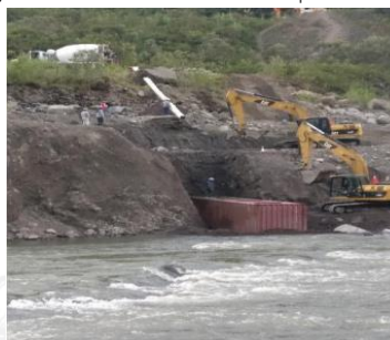
Fotografía 6. Trabajos de reforzamiento de contenedores y construcción de acceso al río. Fuente: CELEC EP
