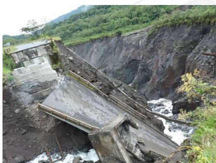
Fotografía 3. Colapso total del puente sobre el río Montana. Fuente: SNGRE CZ2 UMEVA Napo Orellana
