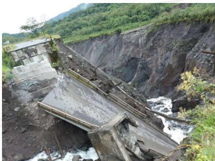
Fotografía 3. Colapso total del puente sobre el río Montana. Fuente: SNGRE CZZ UMEVA Napo Orellana
