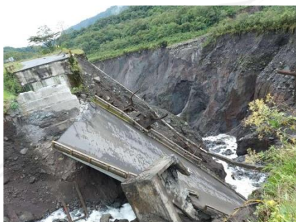
Fotografía 3. Colapso total del puente sobre el río Montana. Fuente: SNGRE C22 UMEVA Napo Orellana
