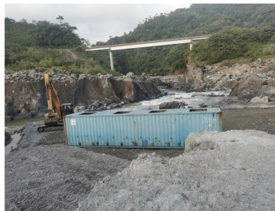
Fotografía 4. Trabajos de reforzamiento de contenedores y construcción de acceso al río. Fuente: CELEC EP
