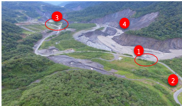
Fotografía 2. Situación vial a causa de la erosión del río – vía Y de Baeza – Lago Agrío. Fuente: MTT3
