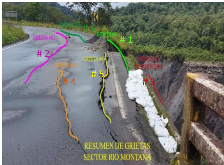
Fotografía 3. Esquema cronológico de las grietas presentes en la vía E-45, sector río Montana - Fuente GAD El Chaco.
