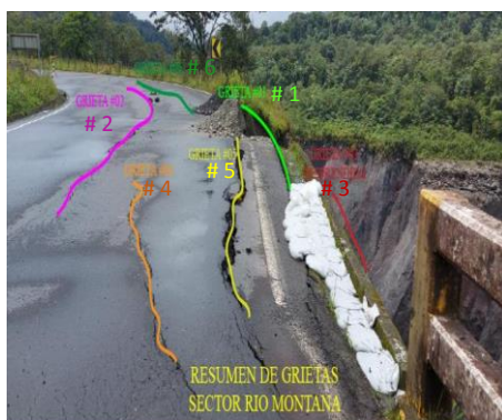
Fotografía 2. Esquema cronológico de las grietas presentes en la vía E-45, sector río Montana - Fuente GAD El Chaco.
