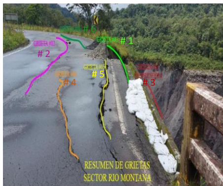
Fotografía 1. Esquema cronológico de las grietas presentes en la vía E-45, sector río Montana - Fuente GAD El Chaco.
