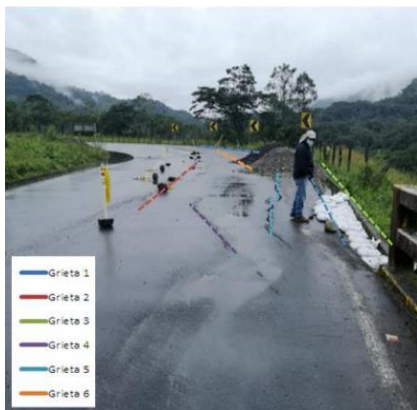
Fotografía 2. Referencia de grietas en la vía, sector río Montana - fuente IJGE.
