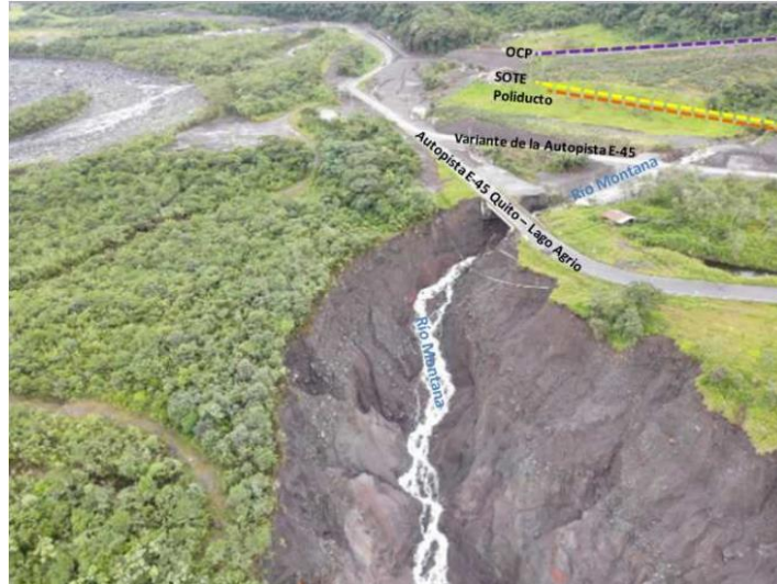
Fotografía 5. Socavamiento del río Montana en la confluencia con el río Coca y afectación en la Autopista E-45 (Fuente: EP Petroecuador, 07/07/2020)
