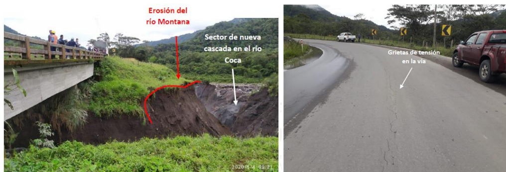
Fotografía 5 y 6. Erosión del río Montana y del puente en la Autopista E45. Fuente: IIGE (04/06/2020)
