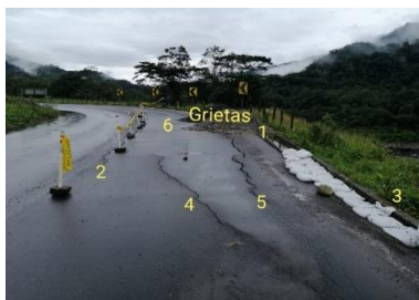
Fotografía 1. Referencia de grietas en la Vía, fuente IIGE.
