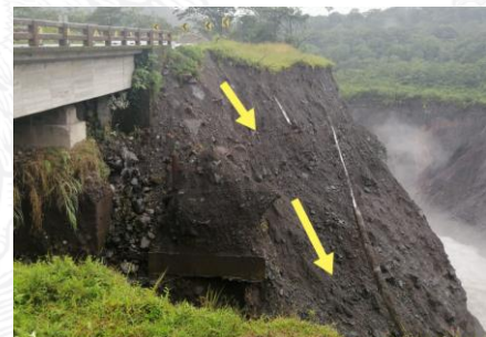
Fotografía 3. Erosión de los taludes en el margen izquierdo del río Montana. Fuente: IIGE
