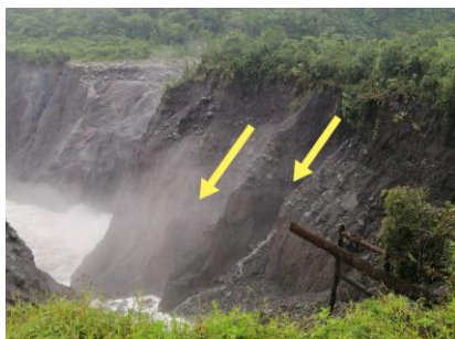
Fotografía 2. Erosión de los taludes en el margen derecho. Fuente: IIGE
