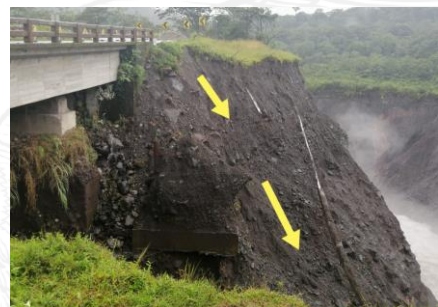
Fotografía 3. Erosión de los taludes en el margen izquierdo del río Montana. Fuente: IIGE
