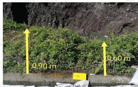
Fotografía 3. Distancia de la vía con el borde de la erosión del margen izquierdo del río Montana. Probablemente en los próximos días la erosión llegue al borde de la vía.
