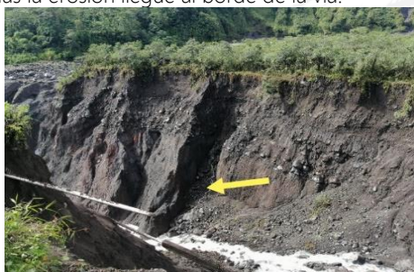
Fotografía 2. Se evidencia la generación de una vertiente de agua y sectores húmedos en los taludes erosionados.
