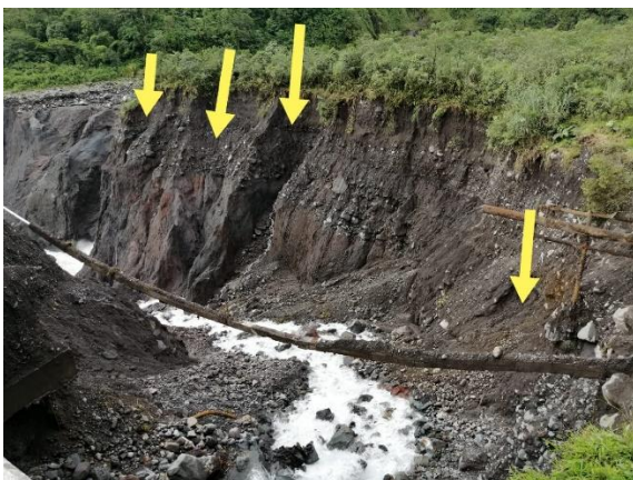
Fotografía 7. Talud derecho del río Montana se observa en varios sitios desprendimiento de material poco consolidado continuando de manera constante la erosión en este sector.
