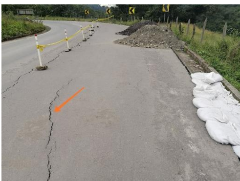
Fotografía 1. Grietas entre eje de la vía y cuneta presentan desplazamiento registrados con una abertura de 1 cm.
