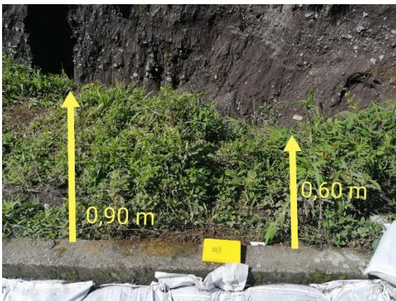
Fotografía 5. La grieta que se encuentra cerca al borde de la erosión del margen izquierdo del río Montaña está a una distancia que varía de 0,60 m a 0,90 m. Lo que indicaría que en los próximos días la erosión llegue al bordillo de la vía con un plano de desprendimiento a través de la grieta.
