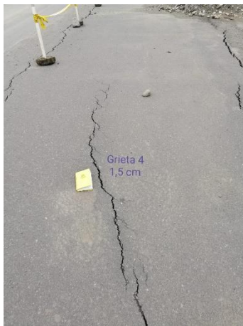
Fotografía 5. Grieta N° 4: 3 m de longitud y 1,5 cm de desplazamiento.
