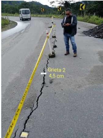
Fotografía 3. Grieta N° 2: 20 m de longitud y 4,5 cm de desplazamiento.
