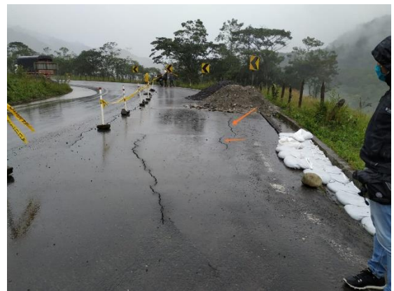
Fotografía 6. Grietas intermedias entre eje de vía y cuneta presentan levantamiento del asfalto (lugares que muestra la flecha). Este levantamiento no estaba presente el día 13/06/2020.
