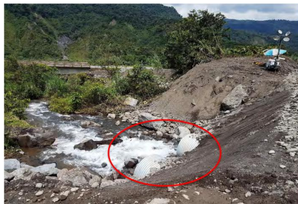
Fotografía 3. Funcionamiento de las 2 alcantarillas de diámetro 1.80 metros, aguas abajo del río Montana.
