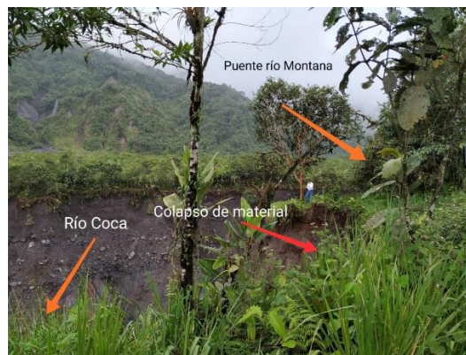
Fotografía 2. Debido al colapso de los taludes de margen izquierdo del río Coca es necesario colocar cintas de peligro para alertar a la comunidad sobre los sectores que presentan alto riesgo para que tengan el cuidado respectivo
