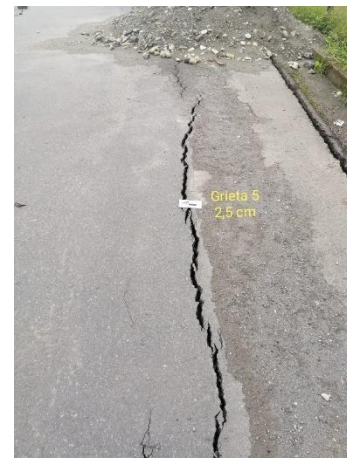
Fotografía 6. Grieta N° 5: 4 m de longitud y 2,5 cm de desplazamiento.
