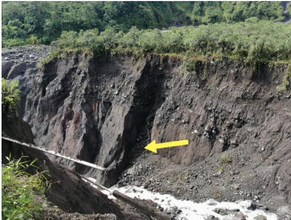
Fotografía 3. Margen derecho. Nótese la generación de una vertiente de agua en la base del estrato conglomerático, además se observa varios sectores húmedos en los taludes erosionados.
