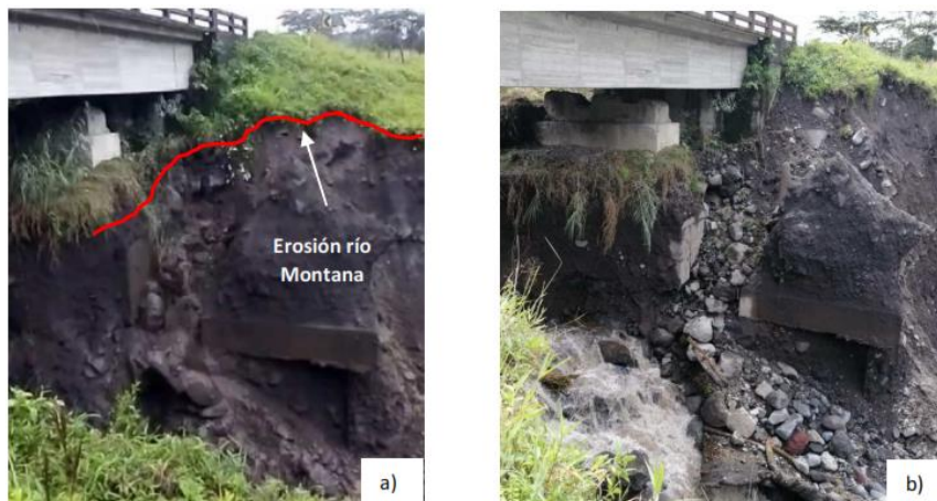
Fotografía 1. a) Erosión del río Montana al 05 de junio de 2020. b) Erosión del río Montana al 11 de junio de 2020
