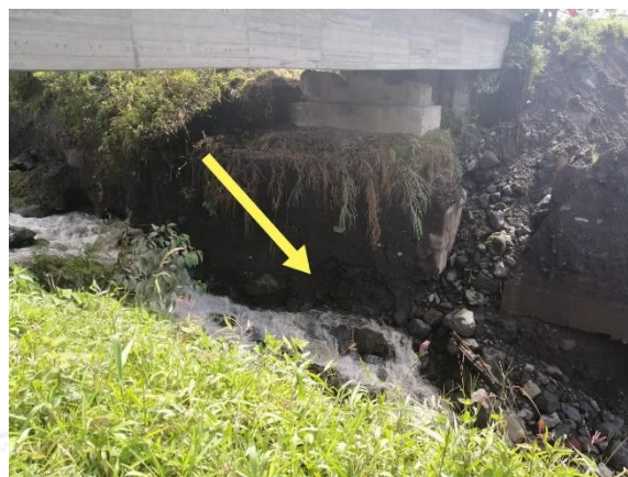
Fotografía 2. Continúa de manera paulatina la erosión de la base izquierda del antiguo puente sobre el río Montana
