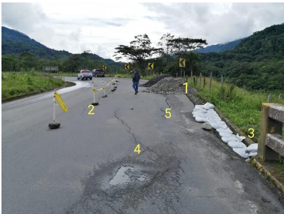
Fotografía 1. Grietas en la autopista E-45 sentido Quito - Lago Agrio. Los números indican la cronología de las diferentes grietas.
