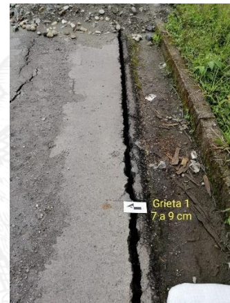
Fotografía 2. Grieta N° 1: 28,5 m de longitud y 7 a 9 cm de desplazamiento.
