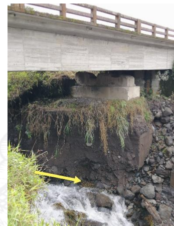
Fotografía 8. Socavamiento de la base izquierda del antiguo puente sobre el río Montana.
