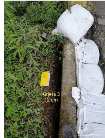
Fotografía 4. Grieta N° 3: 6 m de longitud y 12 cm de desplazamiento.
