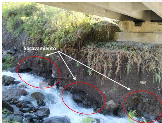
Fotografía 3. Socavamientos en cauce de río Montana.
