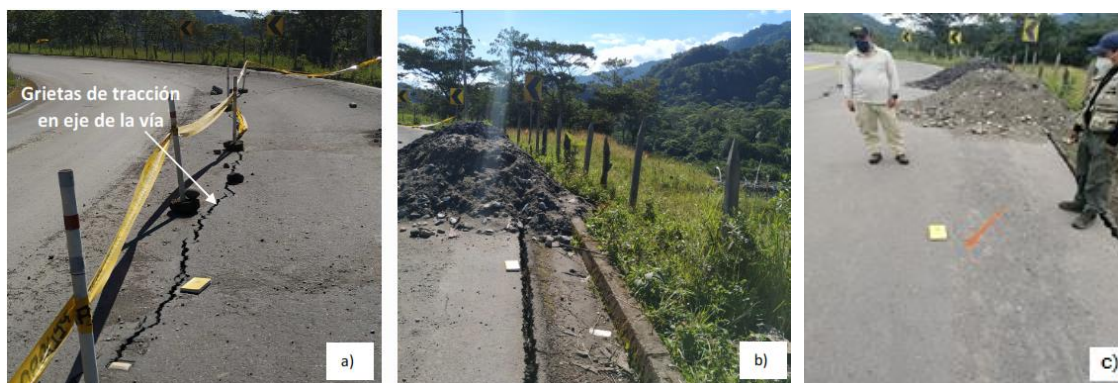
Fotografía 2. a) Grietas de tracción en eje de la Autopista E45. b) Grietas entre asfalto y cuneta en el sector del río Montana. c) presencia de nuevas fisuras en la vía, tramo hacia lago agrío
