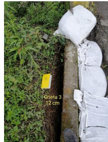
Fotografía 4. Grieta N° 3: 6 m de longitud y 12 cm de desplazamiento.
