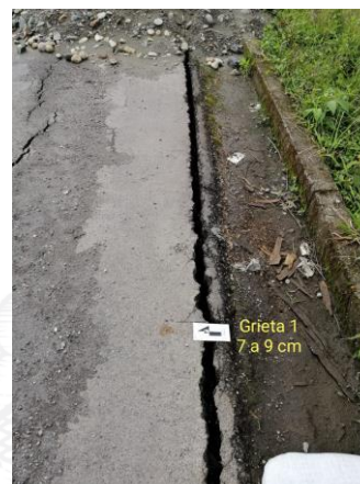
Fotografía 2. Grieta N° 1: 28,5 m de longitud y 7 a 9 cm de desplazamiento.
