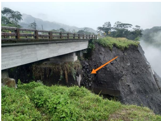
Fotografía 1. Se observa presencia de agua que es conducida por las cunetas que está ingresando a la base de puente en la margen derecha del río Montana.
