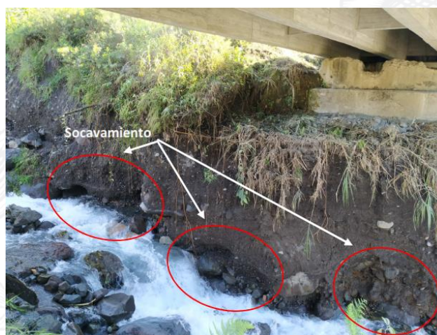
Fotografía 3. Socavamientos en cauce de río Montana.
