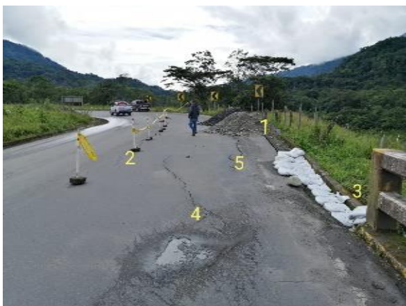
Fotografía 1. Grietas en la autopista E-45 sentido Quito - Lago Agrio. Los números indican la cronología de las diferentes grietas.
