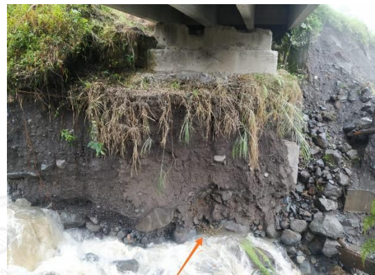
Fotografía 2. Socavamiento de la margen izquierda del río Montana.
