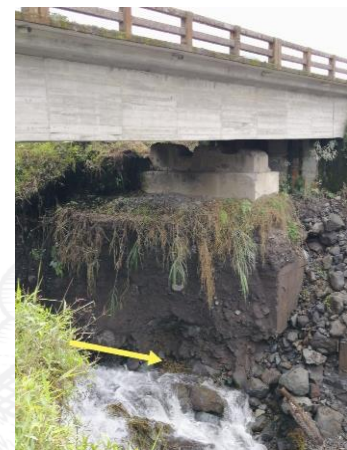
Fotografía 8. Socavamiento de la base izquierda del antiguo puente sobre el río Montana.
