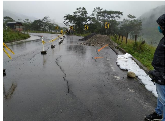
Fotografía 6. Grietas intermedias entre eje de vía y cuneta presentan levantamiento del asfalto (lugares que muestra la flecha). Este levantamiento no estaba presente el día 13/06/2020.
