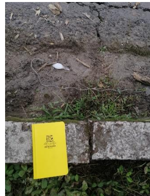
Fotografía 2. En el bordillo de carril derecho rumbo a Lago Agrio presenta grietas con una abertura entre 1,0 a 1,5 cm. En comparación al día de ayer es evidente el desplazamiento en este sector.
