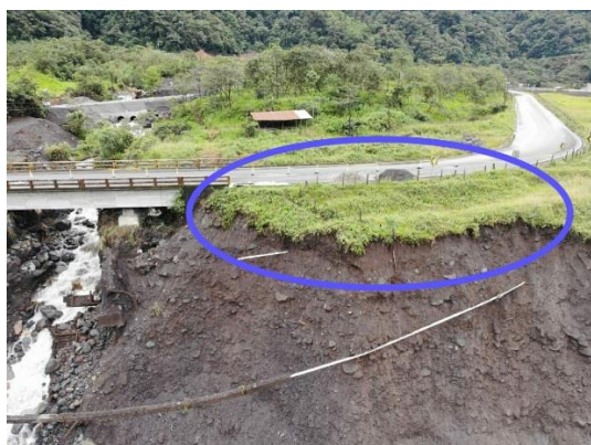
Fotografía 1. Autopista E45, posterior al puente sobre el río Montana (dirección a Lago Agrio). Tramo inestable con presencia de grietas y continuo colapso de material hacia el río Coca.
