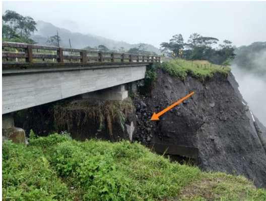
Fotografía 1. Se observa presencia de agua que es conducida por las cunetas que está ingresando a la base de puente en la margen derecha del río Montaña.
