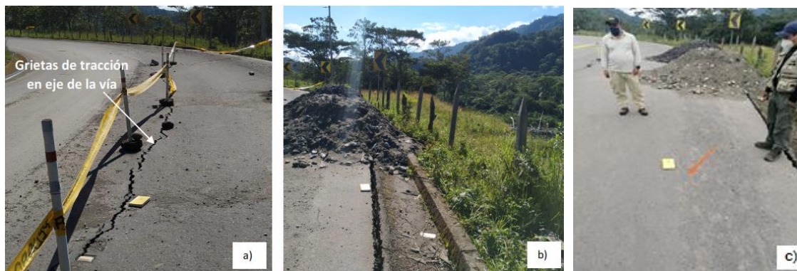
Fotografía 2. a) Grietas de tracción en eje de la Autopista E45. b) Grietas entre asfalto y cuneta en el sector del río Montana. c) presencia de nuevas fisuras en la vía, tramo hacia lago agrio
