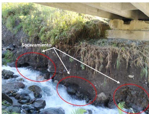
Fotografía 3. Socavamientos en cauce de río Montana.
