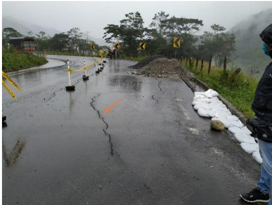
Fotografía 5. Grietas intermedias entre eje de la vía y cuneta presentan una abertura de hasta 2cm. En comparación al día 13/06/2020, tienen un incremento de 1cm. Además se observa un leve hundimiento de lado derecho de la grieta (tramo ubicado con la flecha).
