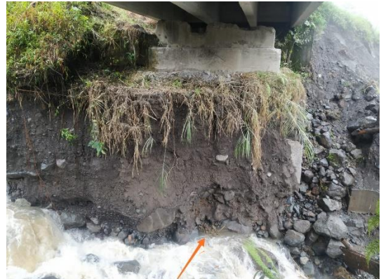
Fotografía 2. Socavamiento de la margen izquierda del río Montaña.
