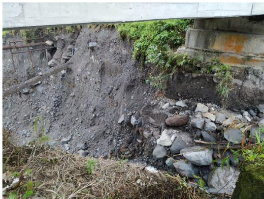
Fotografía 3. Erosión en la margen derecha del río Montaña
