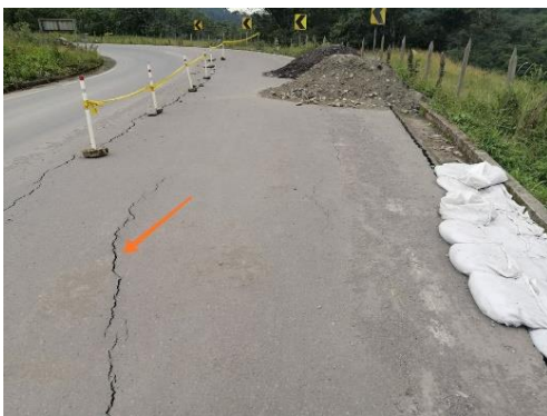
Fotografía 1. Grietas entre eje de la vía y cuneta presentan desplazamiento registrados con una abertura de 1 cm.
