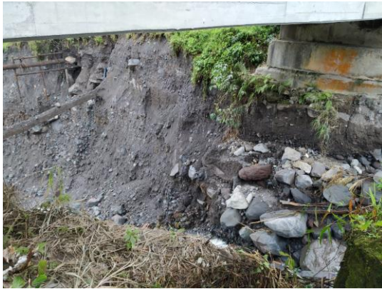
Fotografía 3. Erosión en la margen derecha del río Montana
