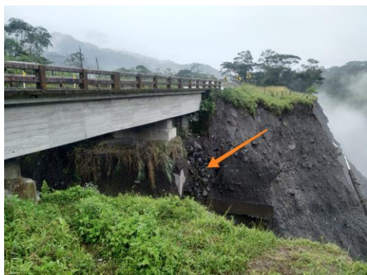
Fotografía 1. Se observa presencia de agua que es conducida por las cunetas que está ingresando a la base de puente en la margen derecha del río Montana.
