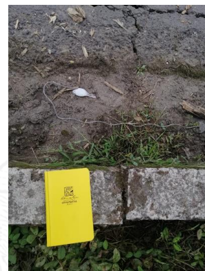
Fotografía 2. En el bordillo de carril derecho rumbo a Lago Agrio presenta grietas con una abertura entre 1,0 a 1,5 cm. En comparación al día de ayer es evidente el desplazamiento en este sector.
