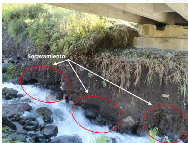
Fotografía 3. Socavamientos en cauce de río Montana.
