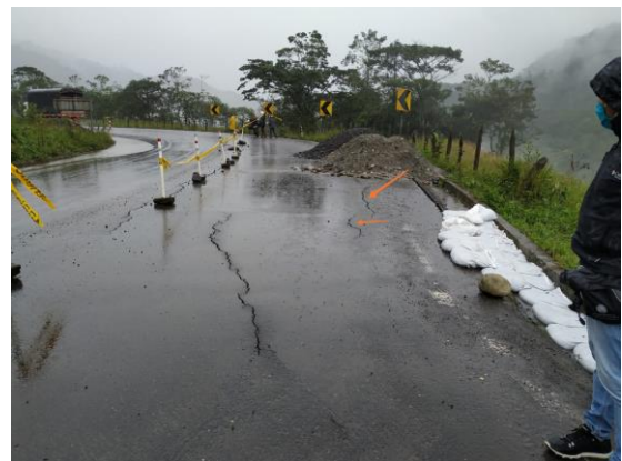
Fotografía 6. Grietas intermedias entre eje de vía y cuneta presentan levantamiento del asfalto (lugares que muestra la flecha). Este levantamiento no estaba presente el día de ayer.
