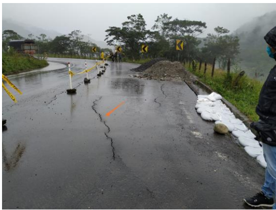
Fotografía 5. Grietas intermedias entre eje de la vía y cuneta presentan una abertura de hasta 2cm. En comparación al día 13/06/2020, tienen un incremento de 1cm. Además se observa un leve hundimiento de lado derecho de la grieta (tramo ubicado con la flecha).
