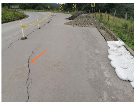
Fotografía 1. Grietas entre eje de la vía y cuneta presentan desplazamiento registrados con una abertura de 1 cm.
