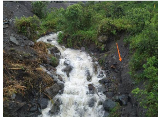
Fotografía 4. Cauce del río Montana aguas arriba del puente. Presenta material fácilmente erosionable, compuesto por bloques centimétricos soportados en una matriz arenosa.
