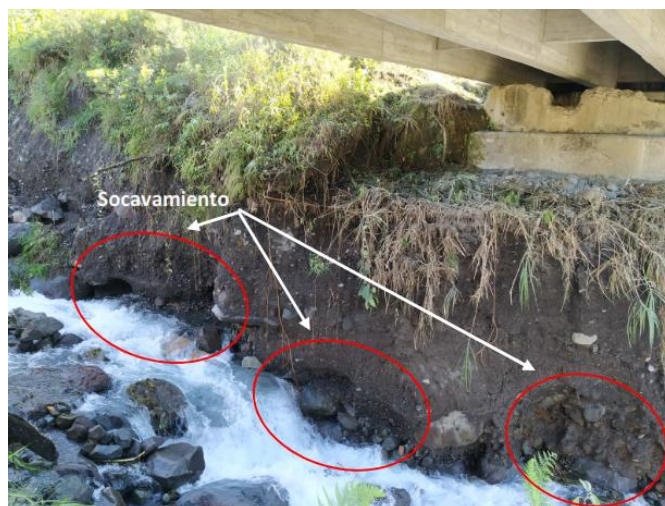
Fotografía 3. Socavamientos en cauce de río Montana.
