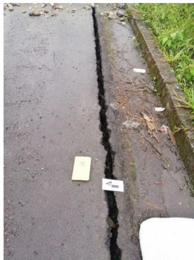
Fotografía 1 Fisuras entre la vía y la cuneta presentan una abertura de 9 cm 09/06/2020, Fuente: IIGE
