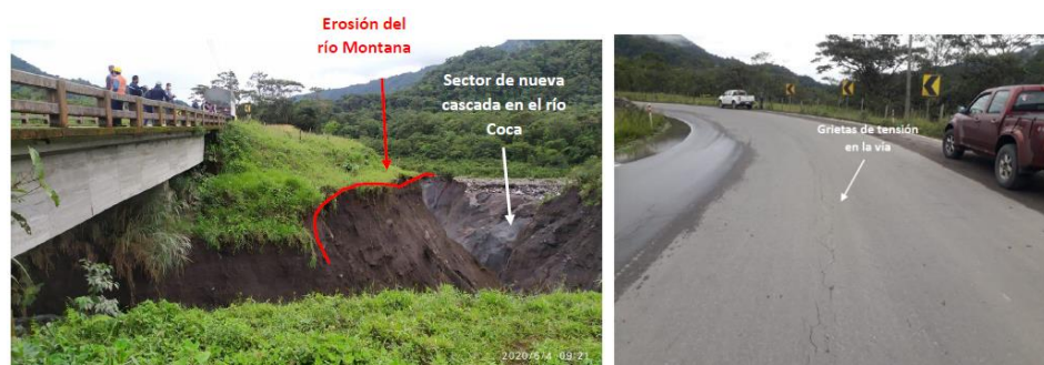
Fotografía 5 y 6. Erosión del río Montana y del puente en la Autopista E45. Fuente: IIGE (04/06/2020)
