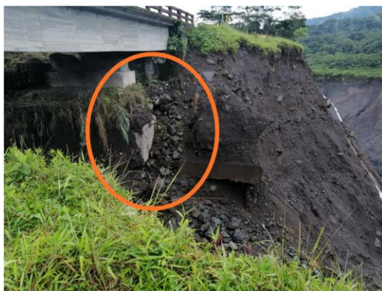
Fotografía 2, Margen izquierdo de río Montana se observa erosión en la base del puente. Fuente: IIGE (10/06/2020)
