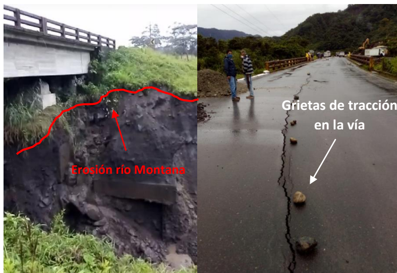
Fotografía 3 y 4. Estado actual de la erosión del río Montana y del puente en la Autopista E45. Fuente: IIGE (05/06/2020)
