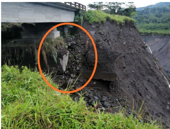
Fotografía 2, Margen izquierdo de río Montana se observa erosión en la base del puente. Fuente: IIGE (10/06/2020)
