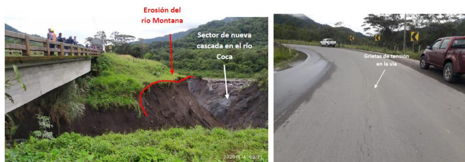
Fotografía 5 y 6. Erosión del río Montana y del puente en la Autopista E45. Fuente: IIGE (04/06/2020)
