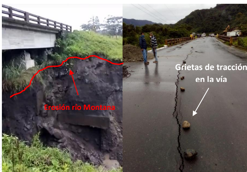
Fotografía 3 y 4. Estado actual de la erosión del río Montana y del puente en la Autopista E45. Fuente: IIGE (05/06/2020)
