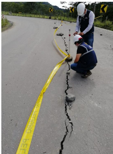
Fotografía 1 Estado actual de la vía - 07/06/2020, Fuente: IIGE
