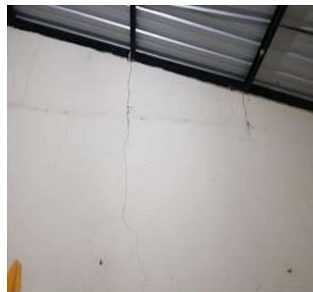
El Oro, fisuras al UPC de la Peña
