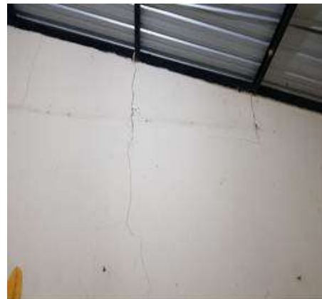
El Oro, fisuras al UPC de la Peña
